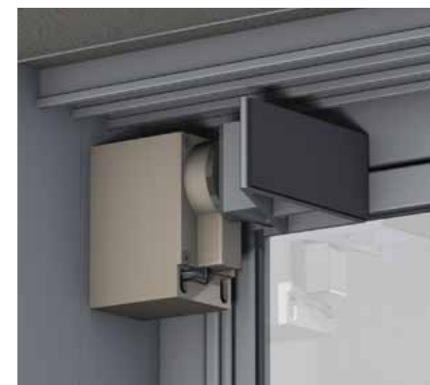
ELEKTROMAGNET Då elektromagneten mottar signaler från rökdetektorn bryts kontakten mellan magneterna. En dold vajerkonstruktion skjuter då luckorna automatiskt åt sidan.
